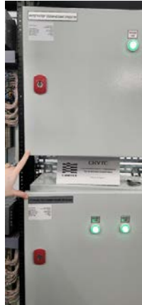
Интегратор ТС и Устройство коммутации питания из состава СКУТС
