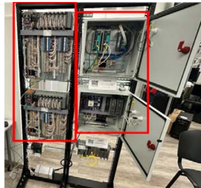
Судовая часть СКУТС, установленная на стенде исполнителя в стойке совместно с блоком СУБО. Элементы СКУТС на рис. выделены красным цветом.
